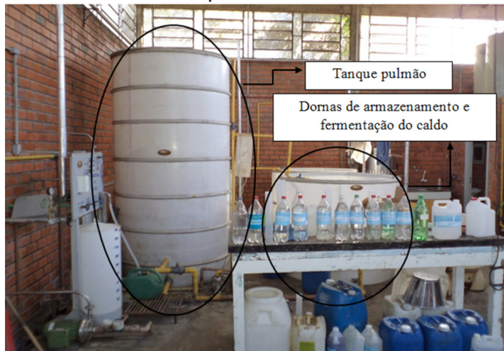
Figura 3 - Setor de armazenamento e fermentação do caldo e tanque pulmão para armazenamento temporário do etanol.
