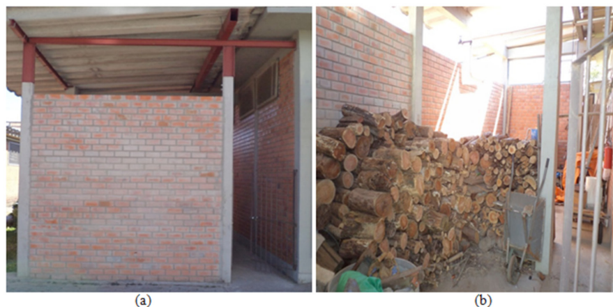
Figura 5 - Casa de caldeira: (a) Vista frontal; (b) Vista interna.
